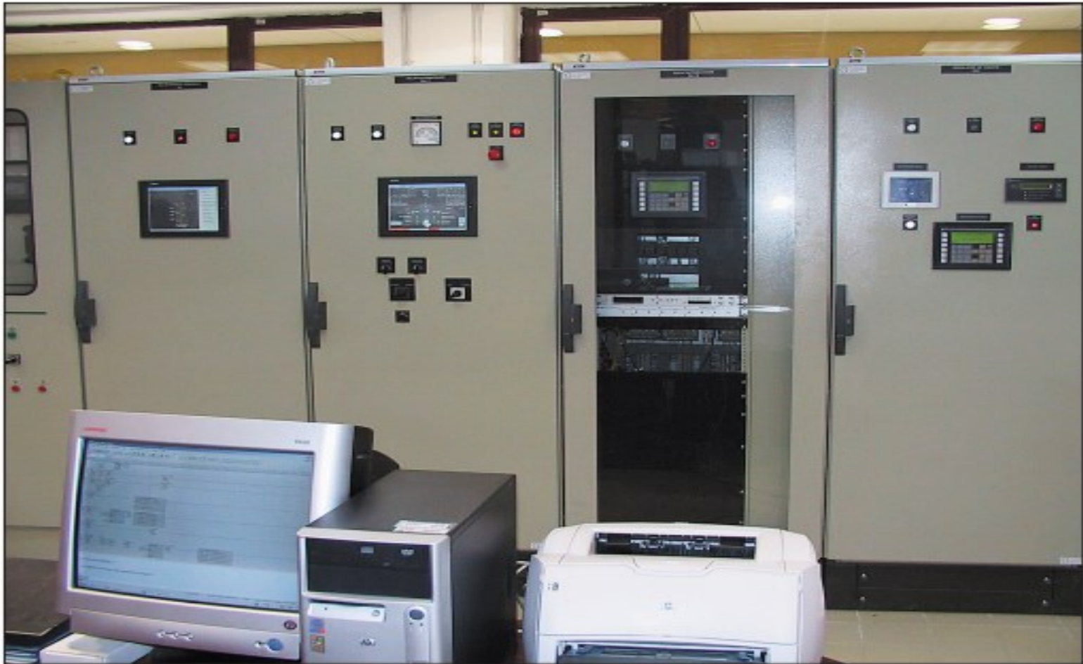
Camera de comanda si dulapurile de control servicii generale centrala, de control, protectie si regulator de viteza hidroagregat
